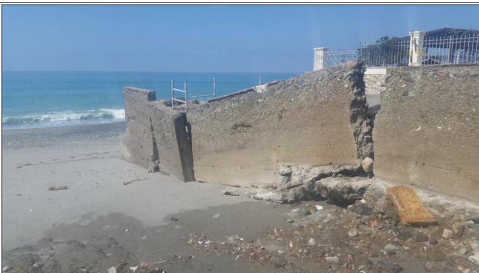
Fig. 21. Fuscaldo, Messinette, un muro di sostegno già danneggiato dalle passate mareggiate ed ulteriormente sconnesso.
