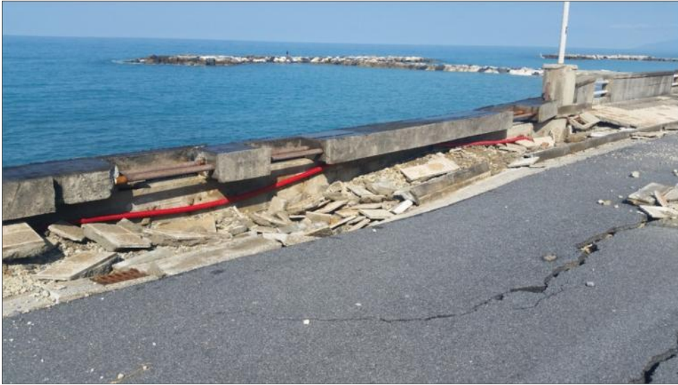
Fig. 7. San Lucido, lungomare, voragine sull'asfalto, danni a marciapiedi, parapetti e sistema di raccolta delle acque piovane.
