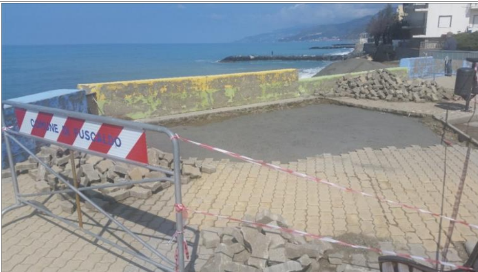
Fig. 17. Fuscaldo, una voragine sul lungomare, più a nord della precedente, prontamente riparata.
