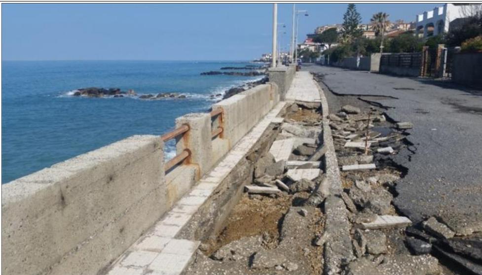
Fig. 5. San Lucido, lungomare, marciapiede e asfalto sconnessi.
