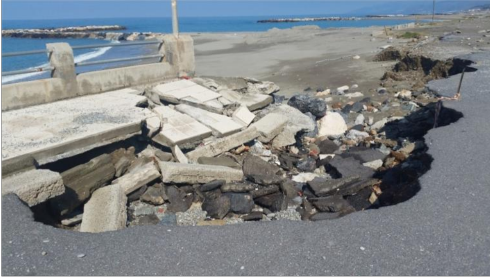
Fig. 10. San Lucido, profonda voragine nell'asfalto al termine nord del lungomare.
