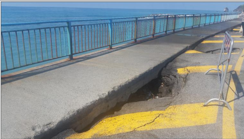
Fig. 23. Guardia Piemontese, voragini sul lungomare nei pressi del ristorante Miramare.
