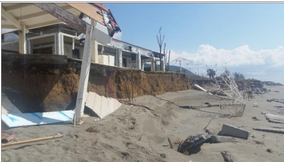
Fig. 33. Bonifati, vista d'insieme dei danni al Lido Florida.
