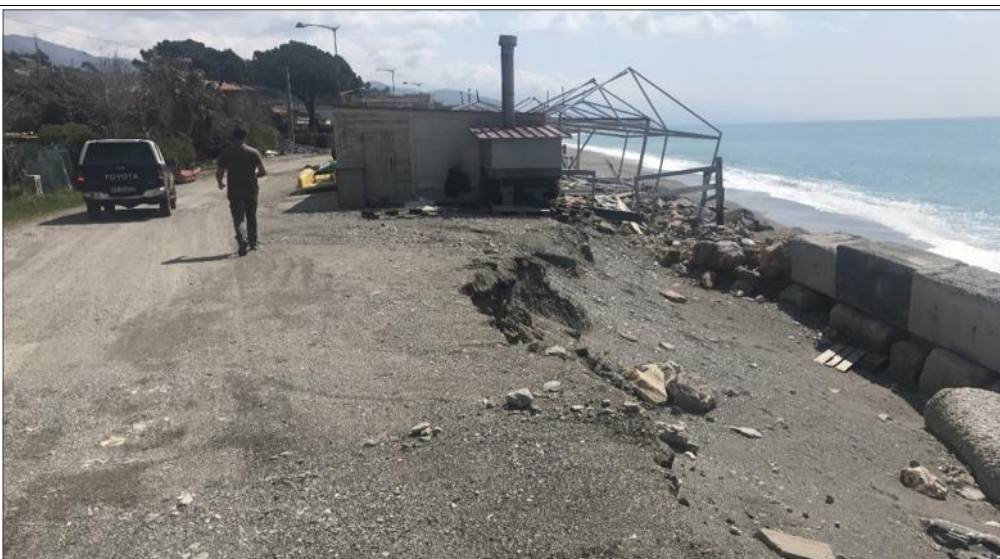
Fig. 30. Cetraro, Lampezia, le strutture del Lido Sunset sono distrutte.
