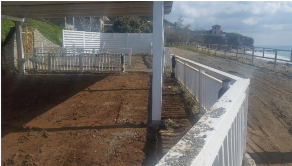
Fig. 38. Bonifati, Cittadella del Capo, i danni alla pavimentazione del bar Tredici & 13 visti da una differente inquadratura.
