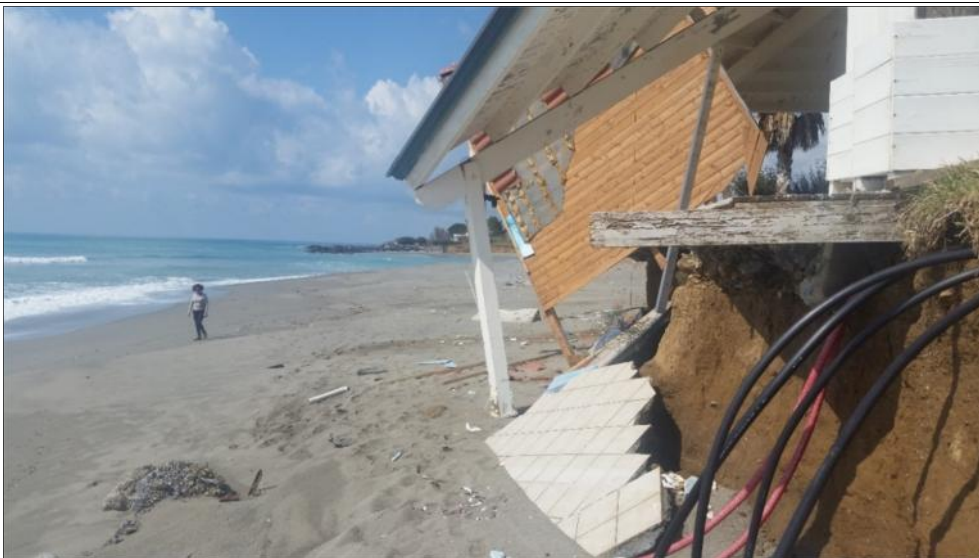
Fig. 32. Bonifati, il Lido Florida visto da sud: l'asportazione della pavimentazione causa il crollo della copertura.
