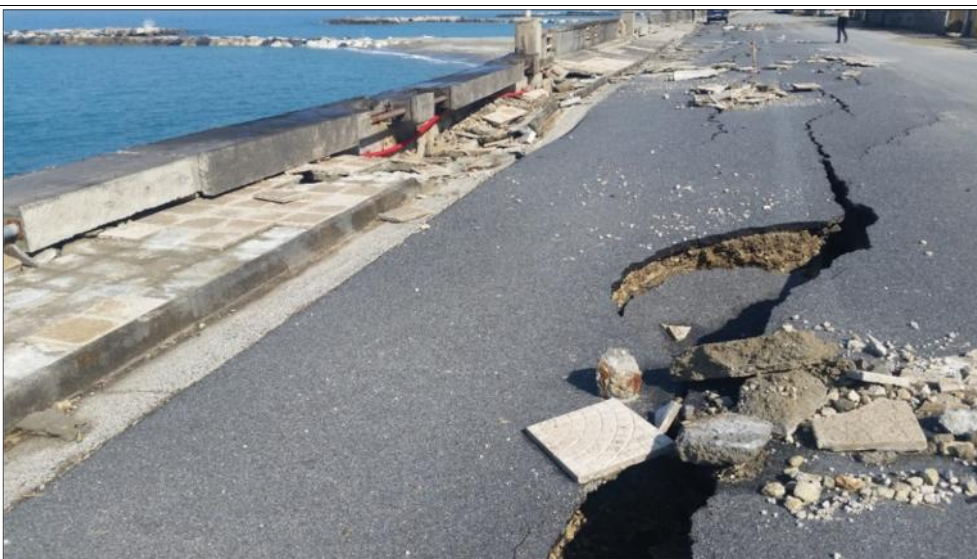
Fig. 6. San Lucido, lungomare, voragine sull'asfalto, danni a marciapiedi, parapetti e sistema di raccolta delle acque piovane.
