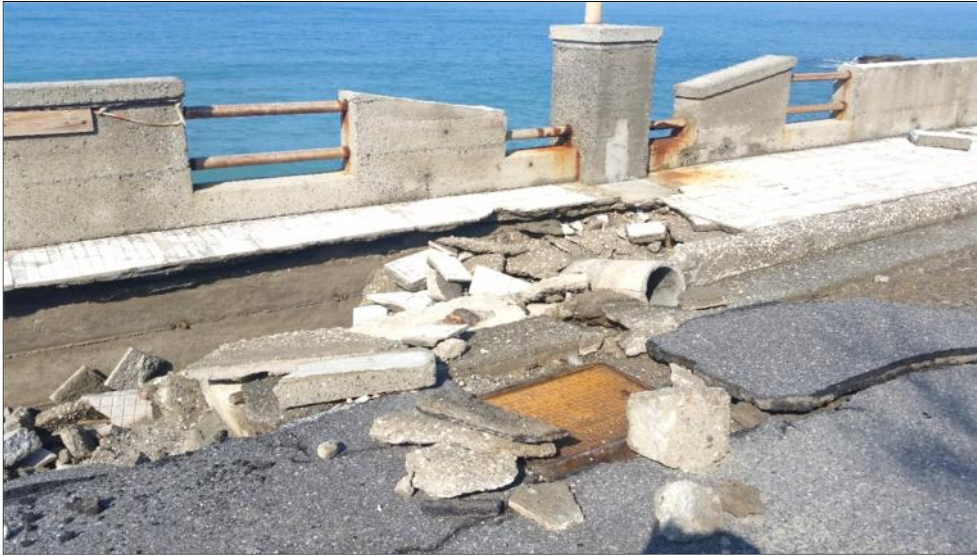
Fig. 4. San Lucido, lungomare, danni al manto stradale, al marciapiede e alle opere di canalizzazione delle acque piovane.
