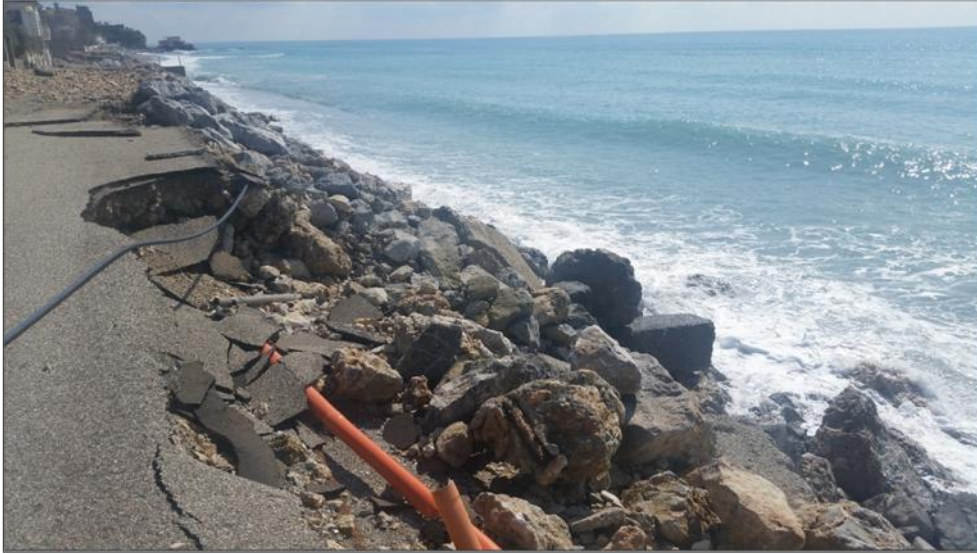
Fig. 34. Bonifati, Cittadella del Capo, la strada lungoriva sotto la stazione ferroviaria di Capo Bonifati è parzialmente asportata dalla mareggiata.
