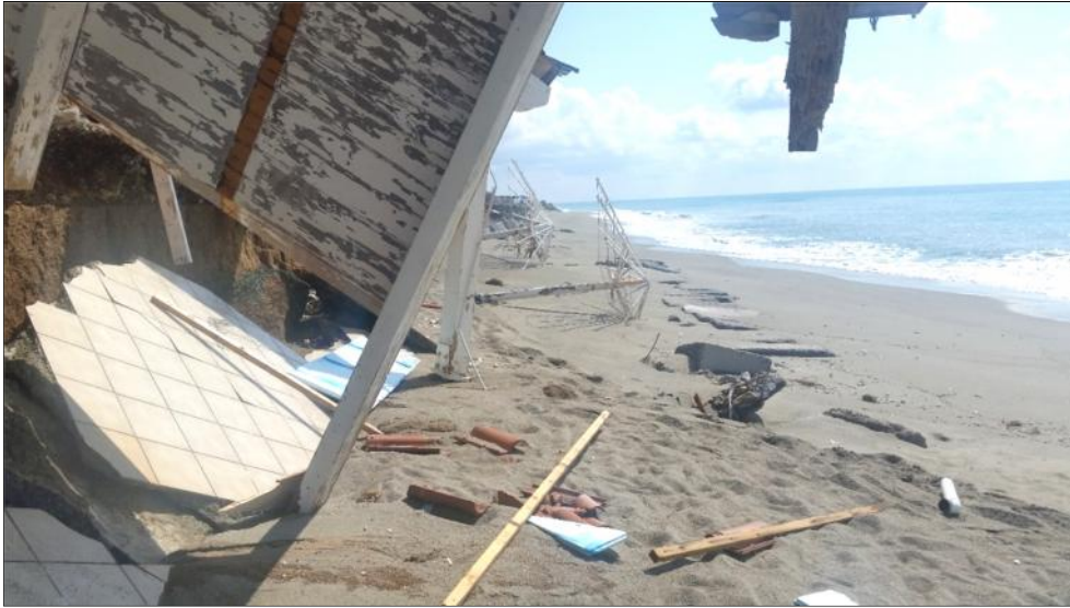
Fig. 31. Bonifati, pavimentazione del Lido Florida asportata dalla mareggiata per una lunghezza di 50 metri.
