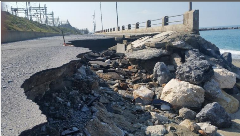
Fig. 11. San Lucido, profonda voragine nell'asfalto al termine nord del lungomare.
