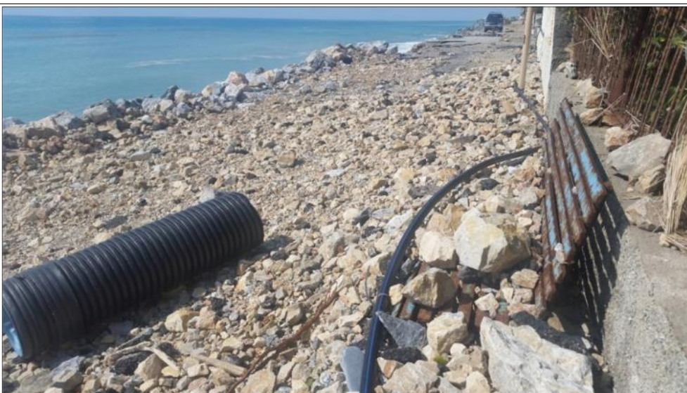
Fig. 36. Bonifati, Cittadella del Capo, la strada lungoriva sotto la stazione ferroviaria di Capo Bonifati. Si noti la panchina in basso a destra sommersa dai detriti.
