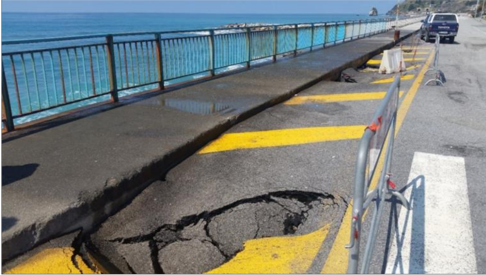
Fig. 22. Guardia Piemontese, voragini sul lungomare nei pressi del ristorante Miramare.
