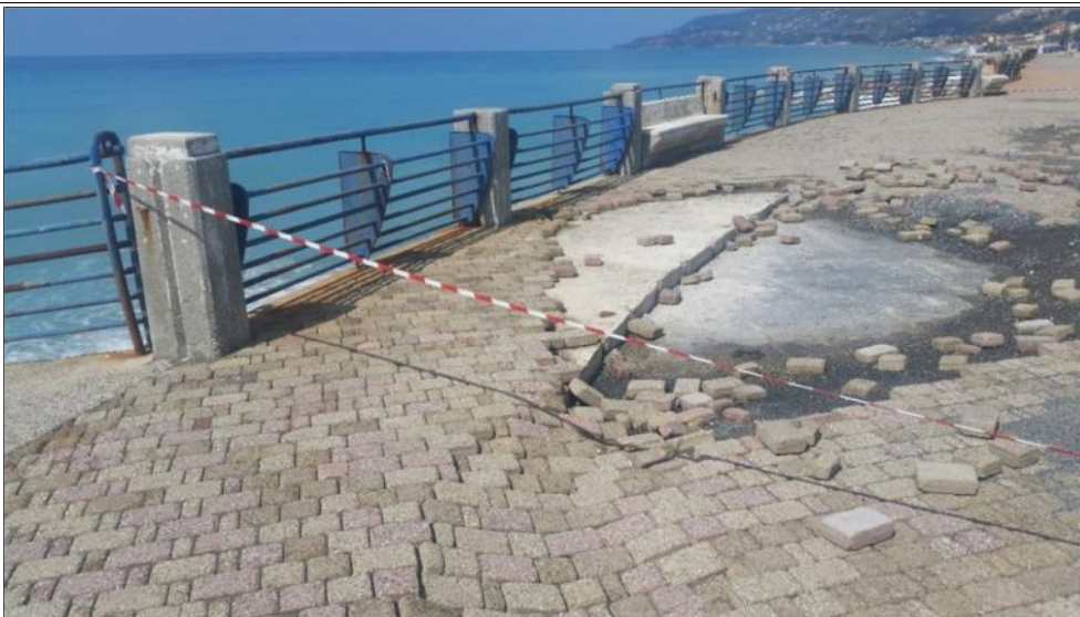
Fig. 26. Acquappesa, voragine sul lungomare.
