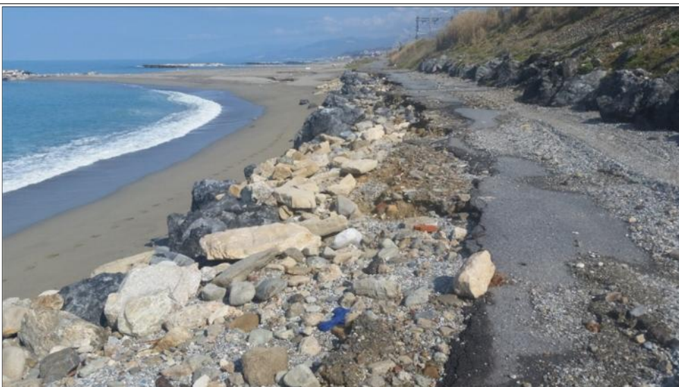
Fig. 12. San Lucido, termine nord del lungomare, strada San Lucido-Paola prospiciente la battigia, parzialmente asportata.
