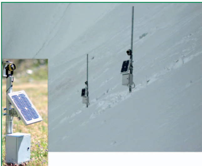
Il sistema di monitoraggio installato sul ghiacciaio delle Grandes Jorasses
